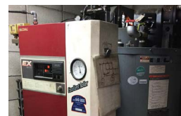
ボイラー等の 特殊専用什器
