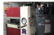
ボイラー等の 特殊専用什器
