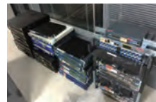
サーバ アンマウント
